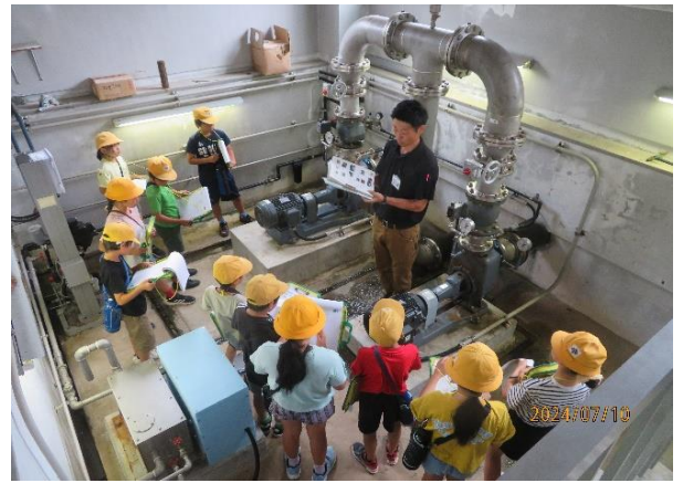
久世浄水場の見学
