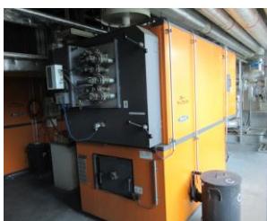
本庁舎の バイオマスボイラー
