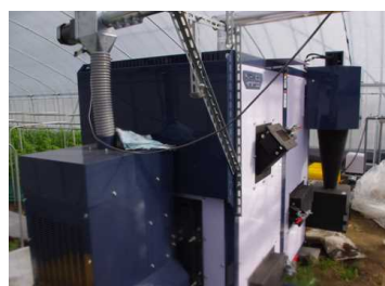
バイオマスボイラー
