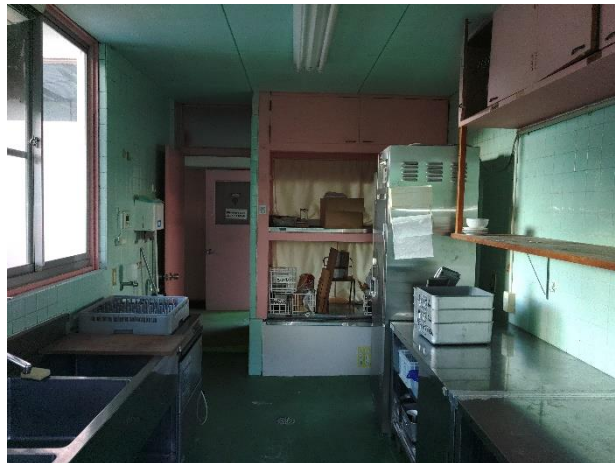
調理室：室内側から入口付近の様子
