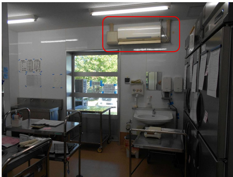
壁掛け設置箇所
