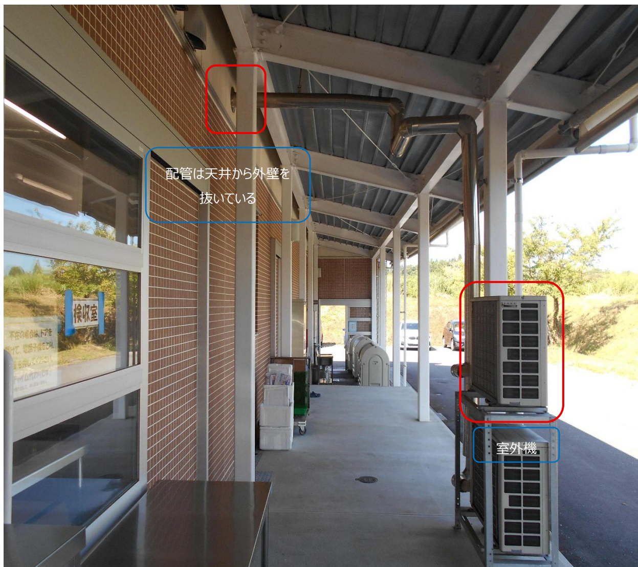
建物外側の配管・室外機
