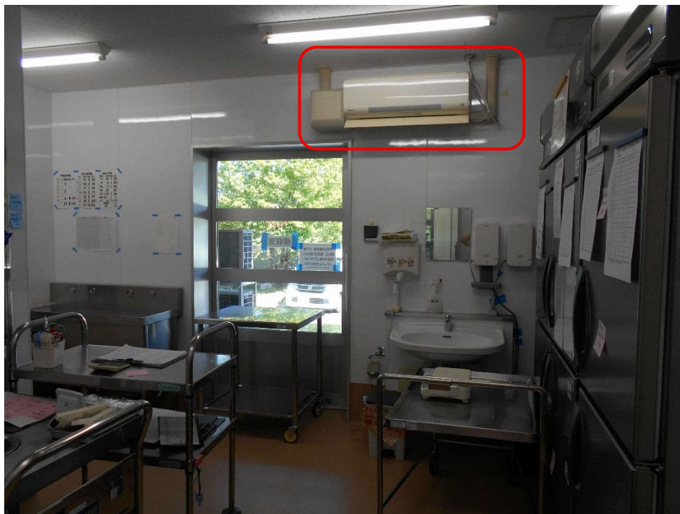
壁掛け設置箇所
