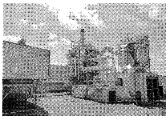
真庭バイオマス発電所(2015 年 4 月運転開始) (真庭市提供)
