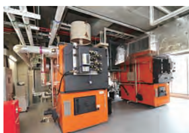
市役所へ導入されたバイオマスボイラー
