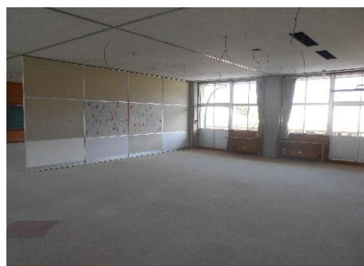
エアコンや電気が取り外された教室
