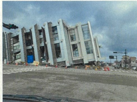
今回の地震の強さを示す (7階建てビルの倒壊)
