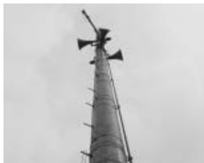
蒜山地内にある屋外放送設備
