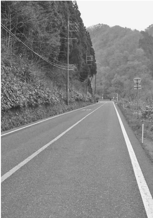
国道313号の落石による危険性がある未改良区域
