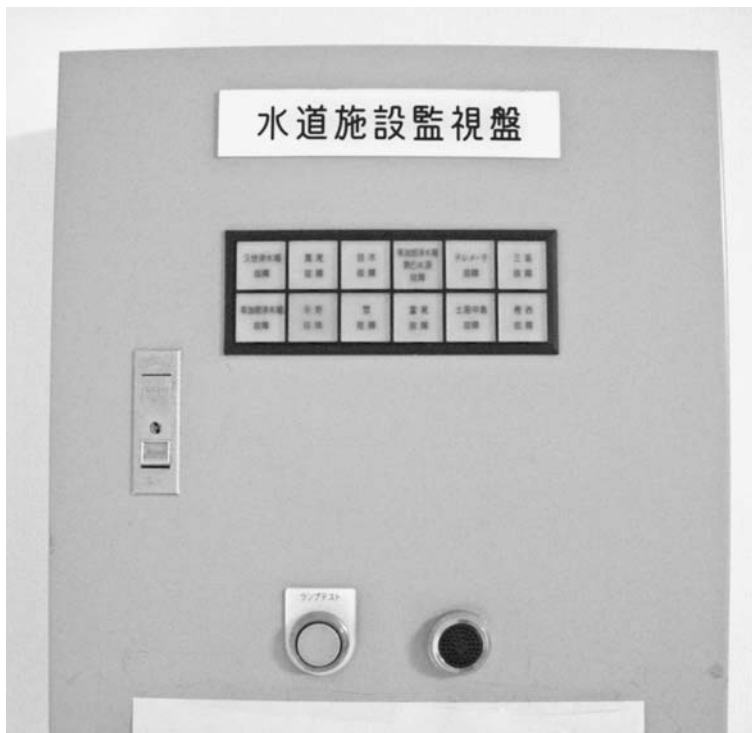
本庁舎に設置された水道施設の中央監視システム
