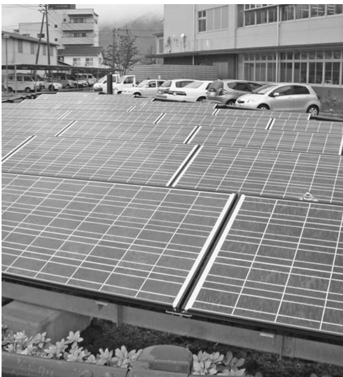
真庭市庁舎に設置したソーラーパネル
