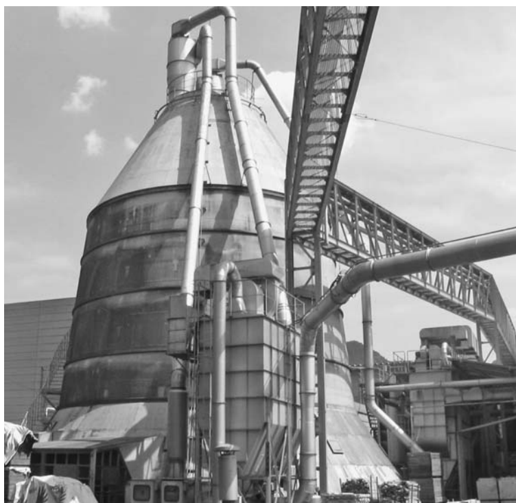
銘建工業に設置されているバイオマス発電施設
