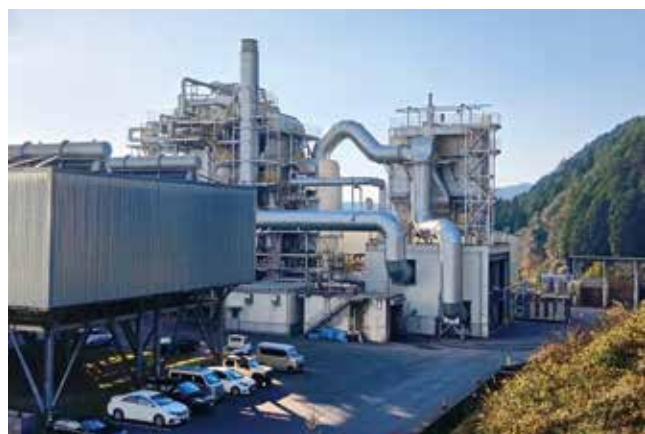
真庭バイオマス発電所 目木
