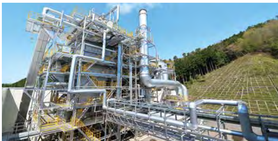
真庭バイオマス発電所
