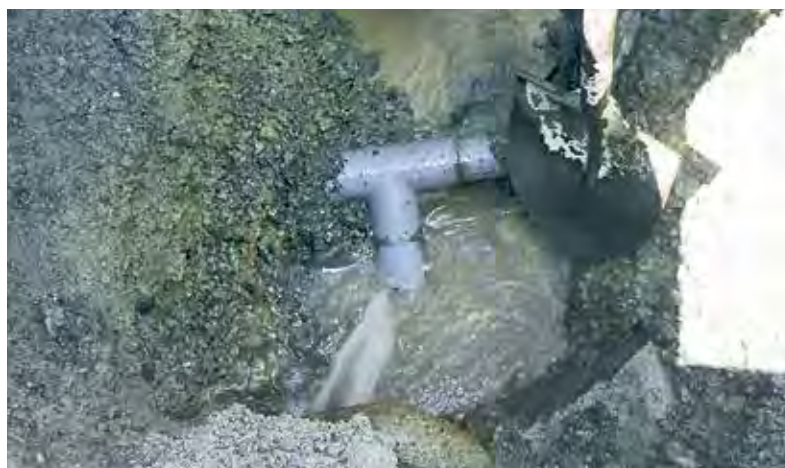
水道の漏水箇所
