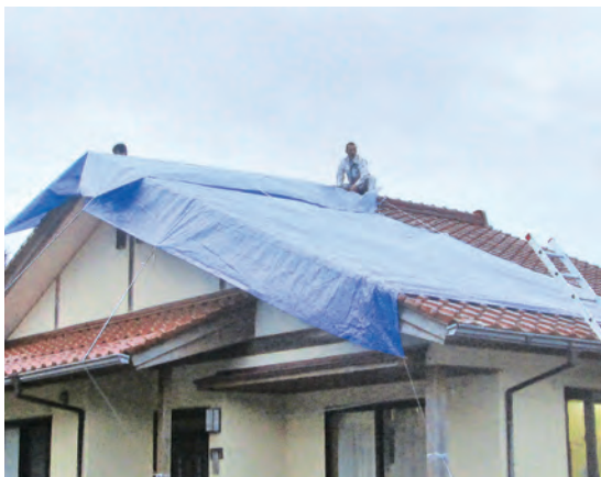
地震により修繕が必要となった市営住宅（蒜山別所地内）
