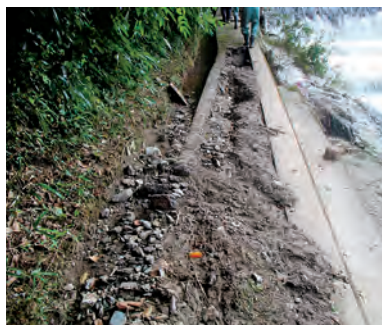
土砂で埋まった水路 落合地内
