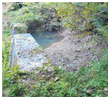
土砂で埋まった堰堤 落合地内
