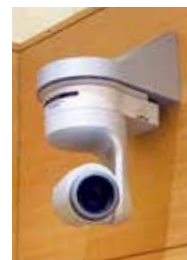
議場に4台の 固定カメラがある
