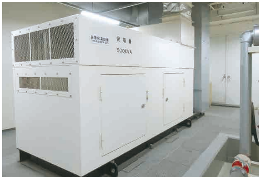
真庭市役所本庁舎に設置している非常用発電機
