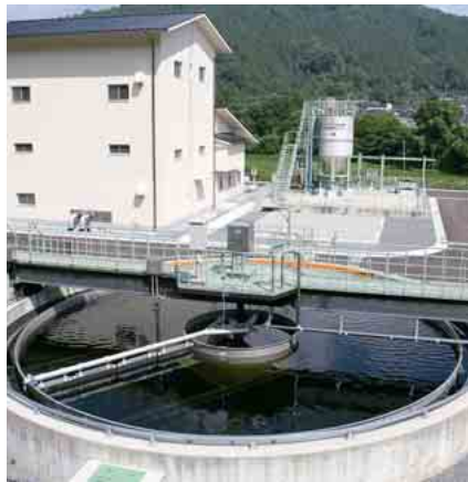
落合浄化センター
