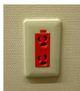
本庁舎非常用コンセント
