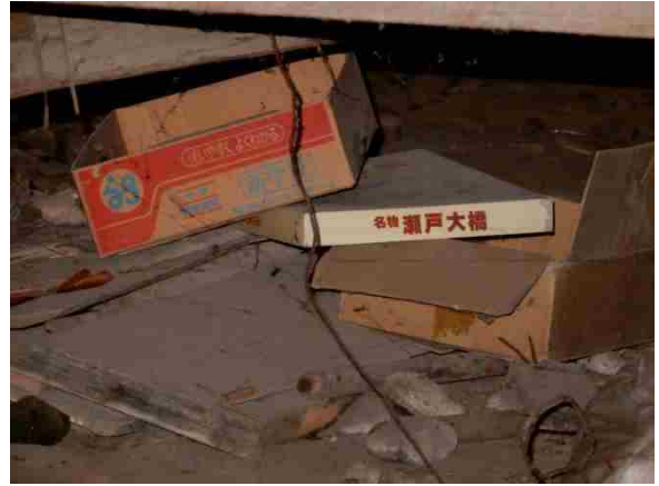
写真7 床下に置かれた段ボール箱
