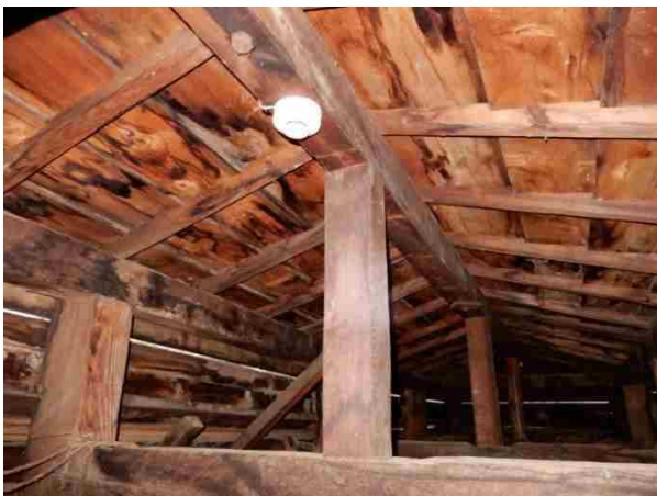
写真12 箱棟内部 雨漏りのシミが残る
