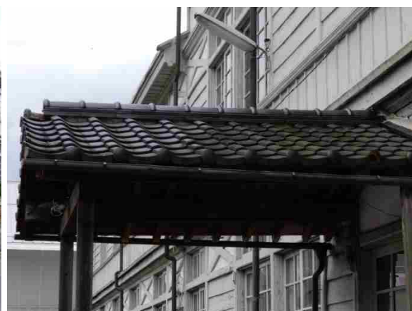
写真 50 屋根瓦は健全だが鬼瓦が欠失している
