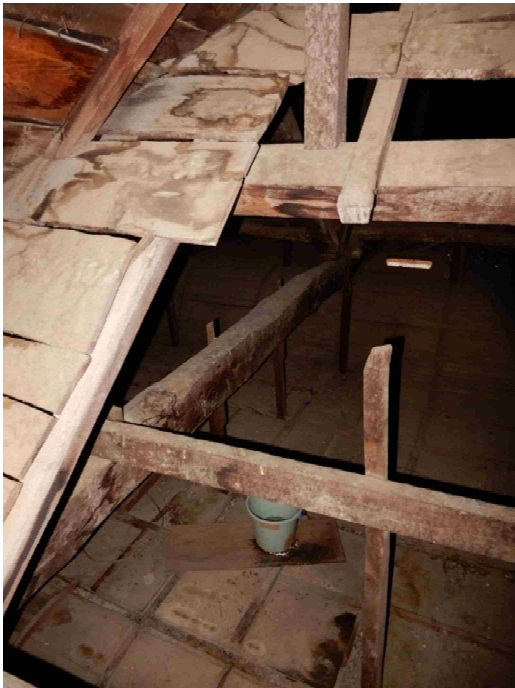
写真 16 野地板に雨染みがある。小屋裏にバケツが置かれている。
