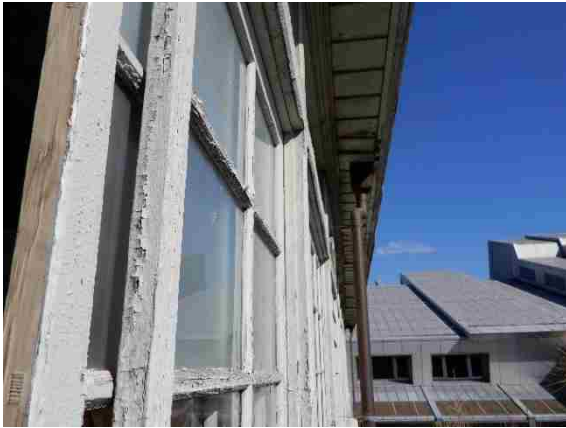
写真 53 窓建具 塗装が経年による浮き剥がれがある
