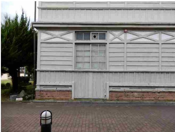
写真 43 ガラス戸、腰を板壁で塞がれている
