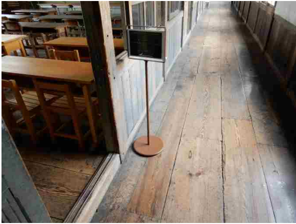
写真 37 廊下の床板に欠けがある
