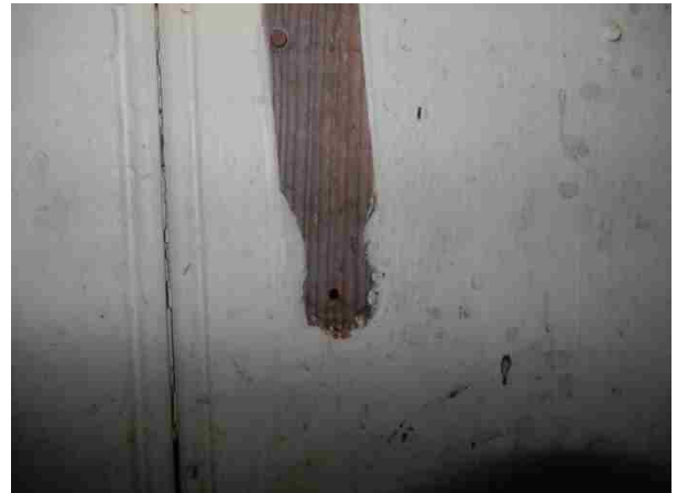
写真 56 一階教室の壁板に棚受け金具が外れた部分があり以前はペンキ塗ではなく、木目の見えるニス等と塗装仕上げと考えられる
