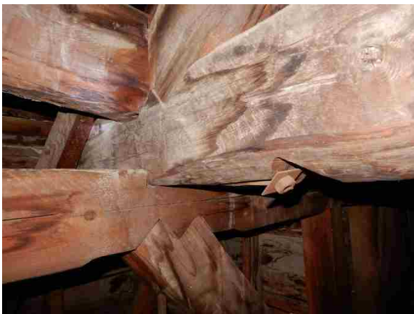
写真28 トラス陸梁端部状態
