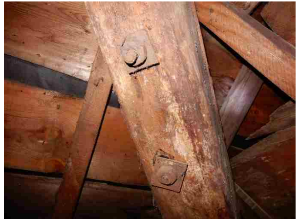
写真27 小屋内部のボルト 緩みがあるものがある
