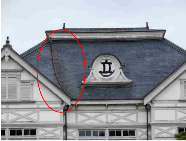
写真20 箱棟からの鎖の錆がスレートに付いている
