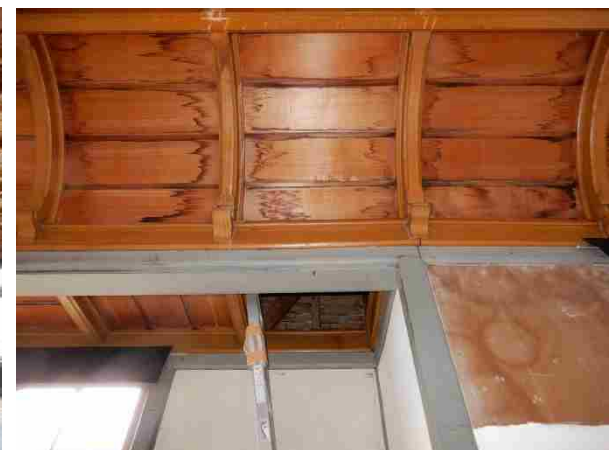
写真 34 講堂天井各所に雨染み痕がある
