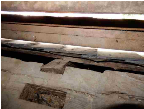
写真 14 箱棟品軒裏 スレート上部に隙間がある
