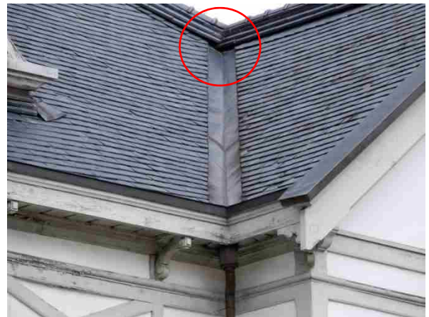
写真 15 谷上部と棟の間に隙間がある
