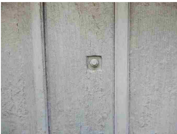
写真8 外壁の状態 経年による塗装の浮きがある。
