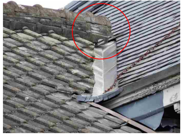
写真21 西翼棟 棟積み 端部が浮いている。
