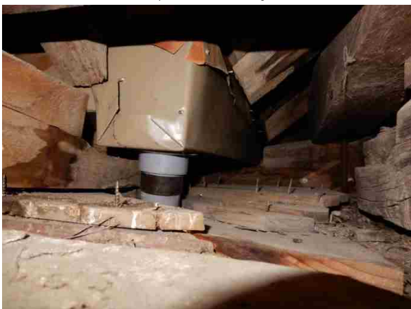
写真 18 谷下部の軒内樋裏に無数の木ネジ補修がある
