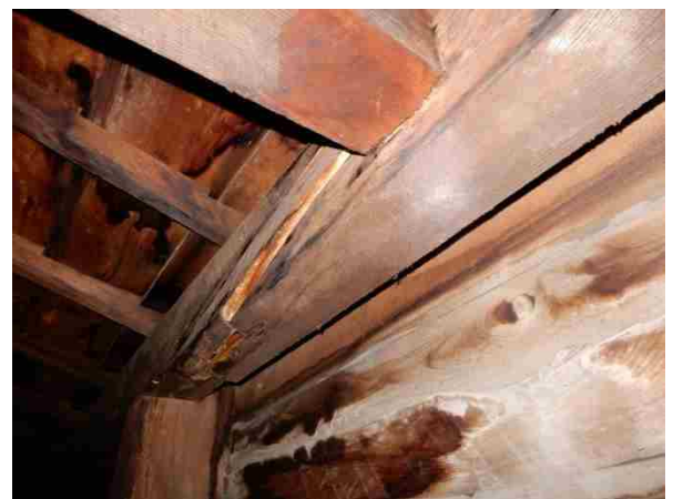
写真29 箱棟桁 変形による割れが起きている
