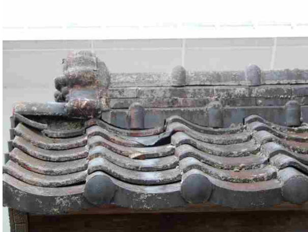
写真 48 経年による痛みが瓦に見られる
