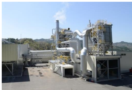
バイオマス発電所
