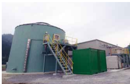
実証プラント全景
