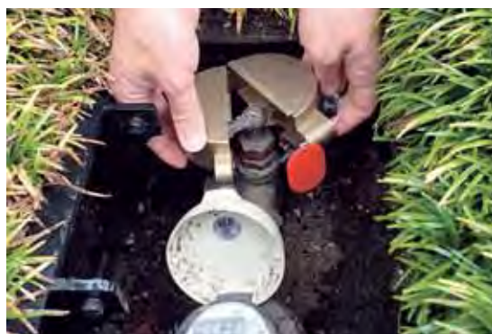
バルブを閉め、金属製の蓋を取り付けて施錠する「給水停止」
