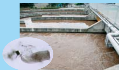
②オキシデーションディッチ タンクの中にすむさまざまな微生物に汚れを食べてもらいます
