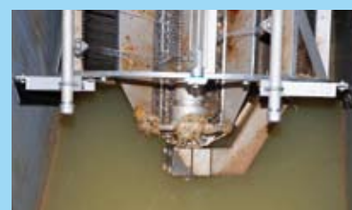
①沈砂池 大きなゴミなどを取り除きます
