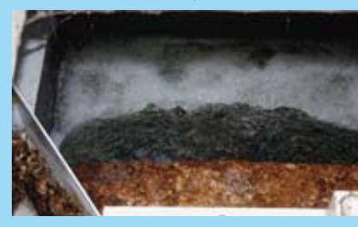
④塩素接触タンク 集まった水を塩素消毒します
